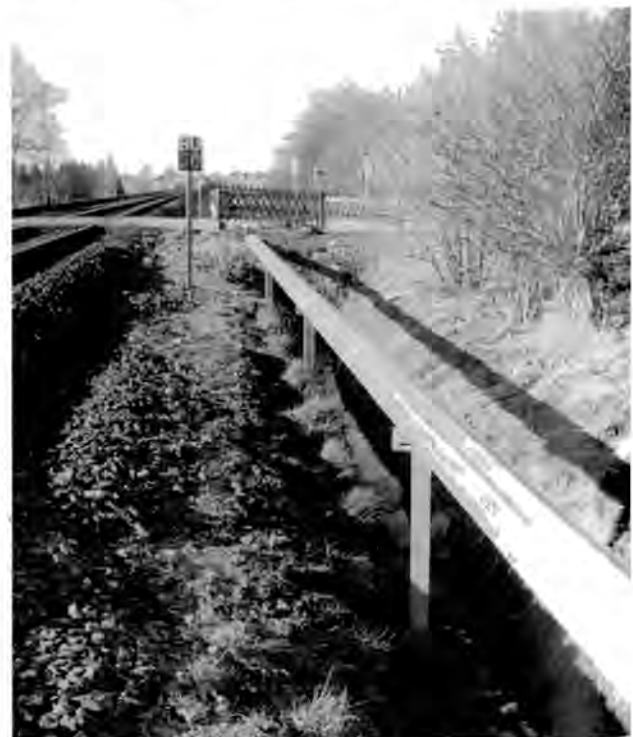
Bilder 3 und 4: Aufgeständerter Kabelkanal
